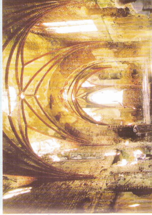
Zustand der schwer beschädigten Gewölbedecke Повреждённый свод
